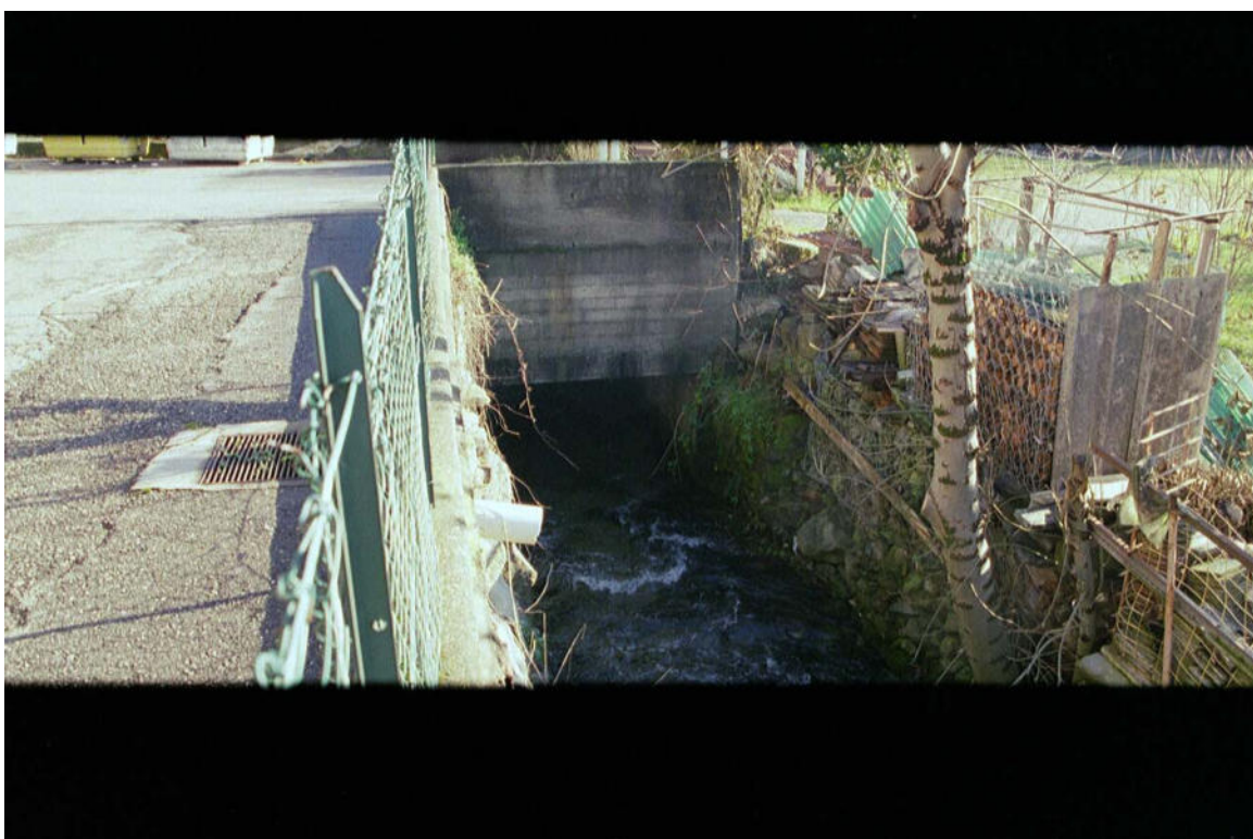
Foto 074 – Opera CANOAG065 . Ripresa da monte verso valle, Canale Comunale, affluente di sinistra del T. Pellice.
