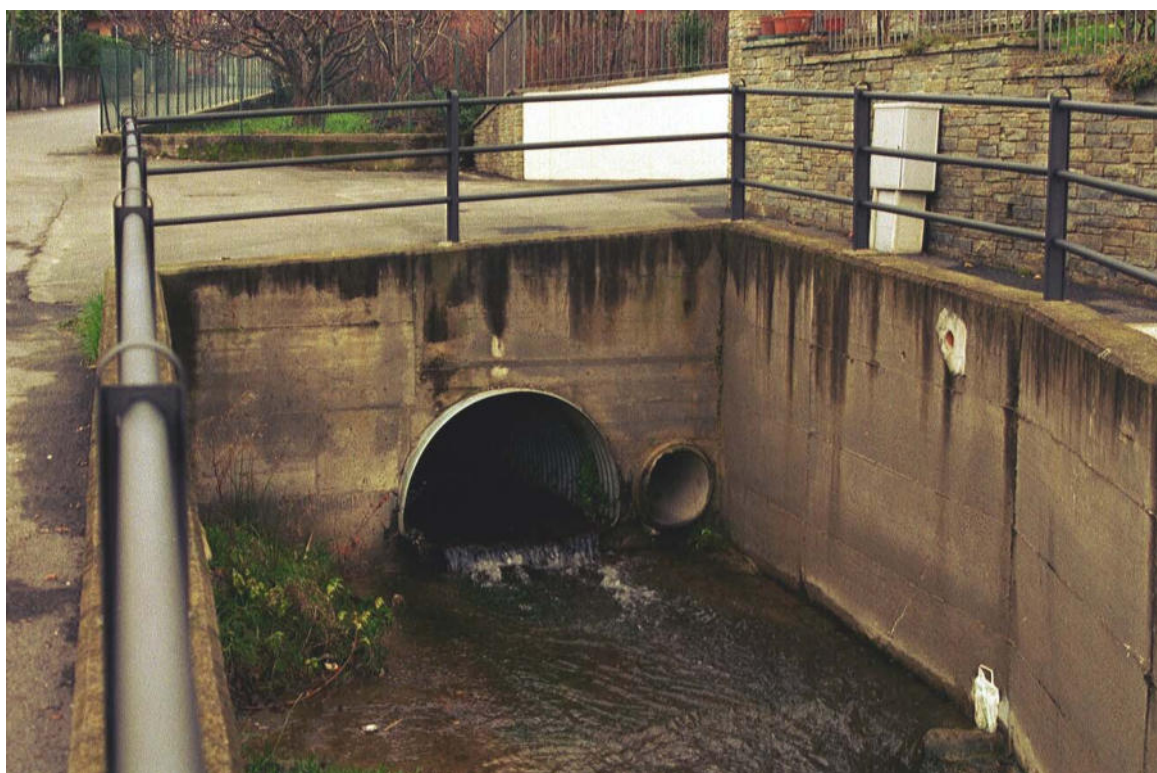
Foto 142 – Opera CANOCA013 . Ripresa da valle verso monte, Rio dei Boer, affluente di sinistra del T. Pellice.
