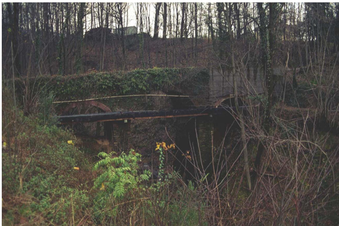
Foto 009 – Opera CANOPO009 . Ripresa da valle verso monte, Rio dei Baussan, affluente di sinistra del T. Pellice.
