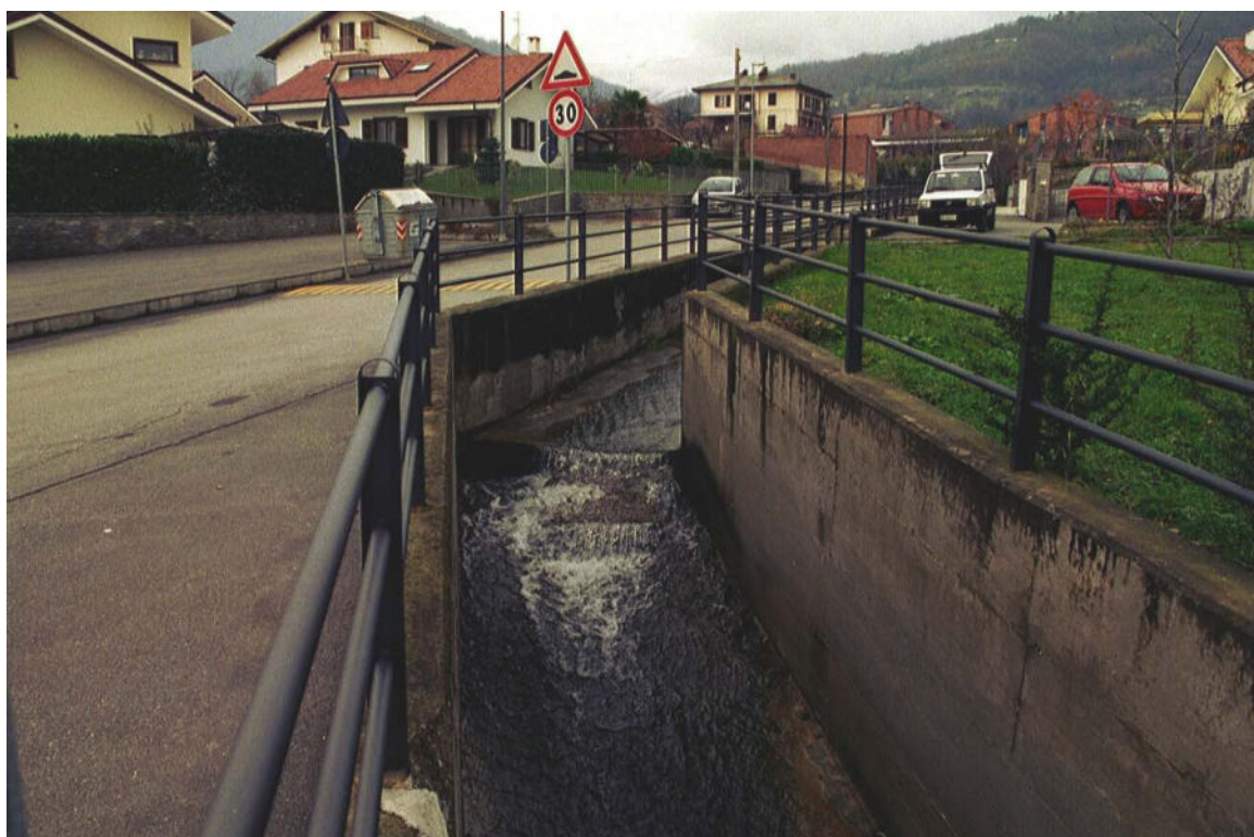
Foto 143 – Opera CANOCA014 . Ripresa da valle verso monte, Rio dei Boer, affluente di sinistra del T. Pellice.
