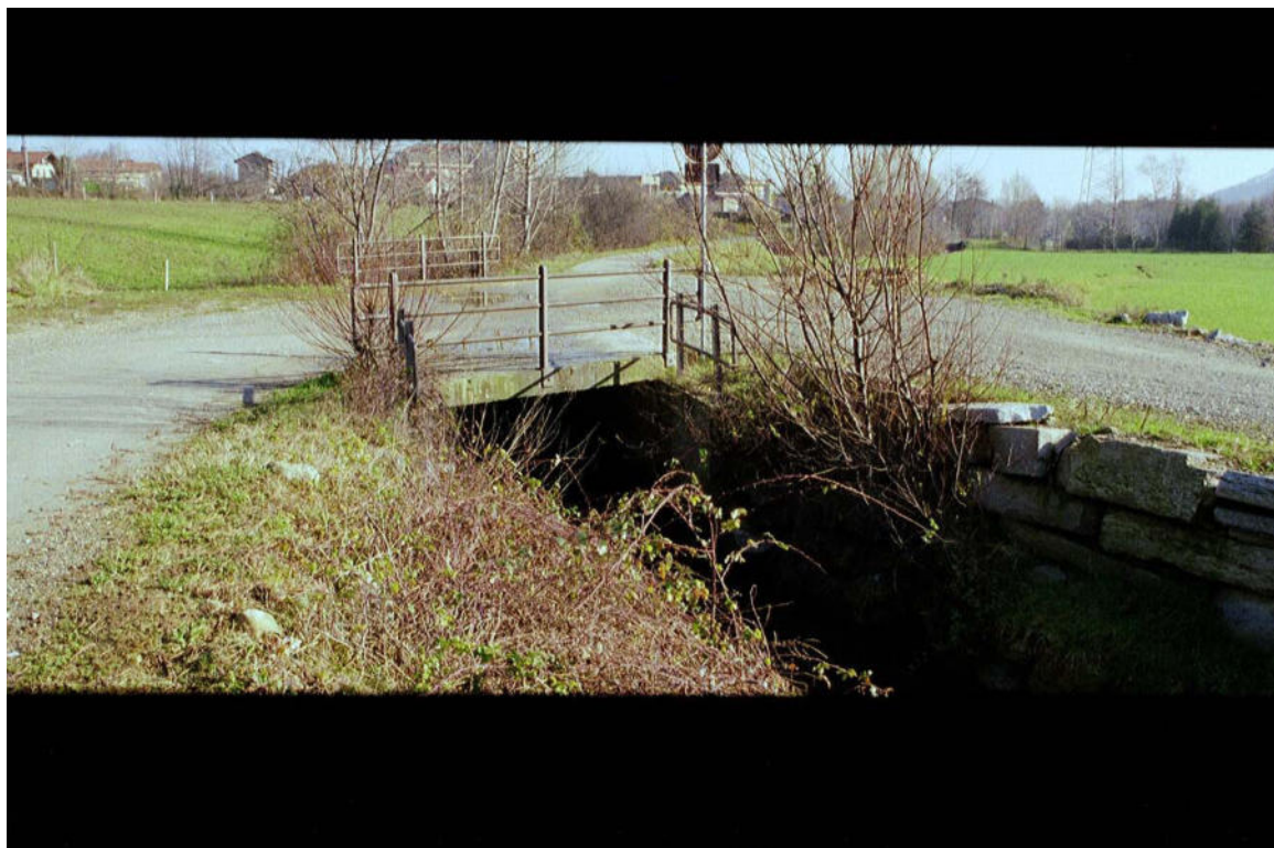
Foto 067 – Opera CANOAG058 . Ripresa da monte verso valle, Canale Comunale, affluente di sinistra del T. Pellice.
