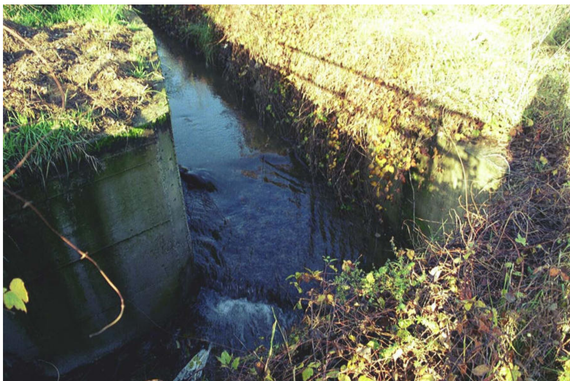
Foto 144 – Opera CANOCA015 . Ripresa da valle verso monte, Rio dei Boer, affluente di sinistra del T. Pellice.
