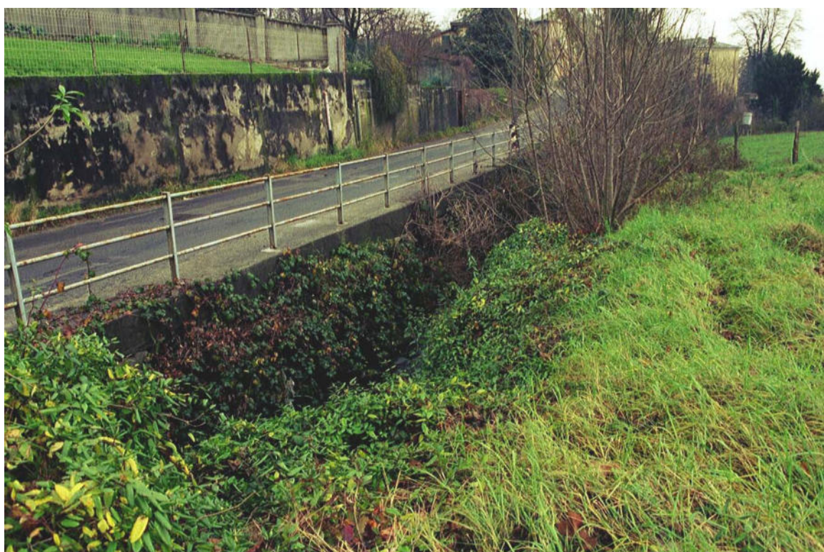
Foto 111 – Opera CANODS048 . Ripresa da monte verso valle, T. Gambrero, affluente di sinistra del T. Pellice.
